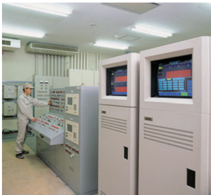
《研磨布製造装置・制御室》
